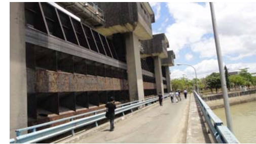
老朽した水門
