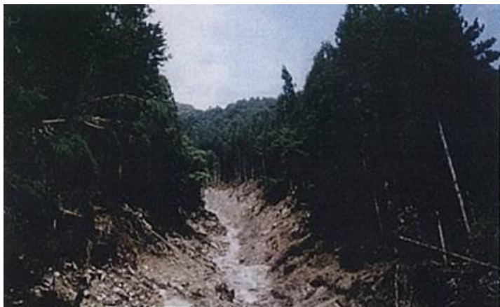
林地の崩壊／達原地内
